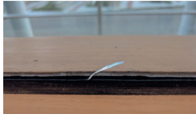
Breuk ontstaan ter plaatse van de inklemming.
